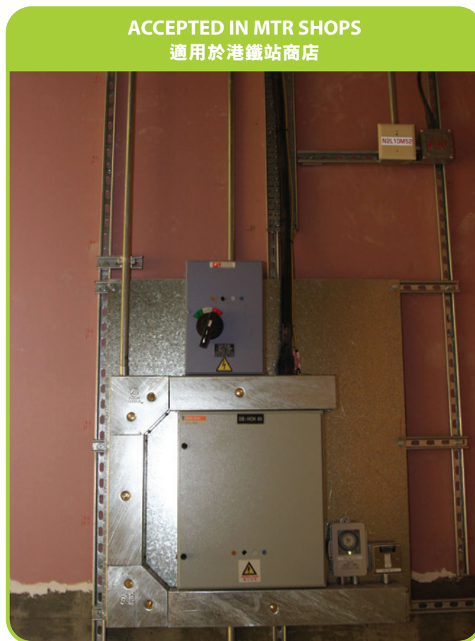
Metal Conduits 金屬導管
